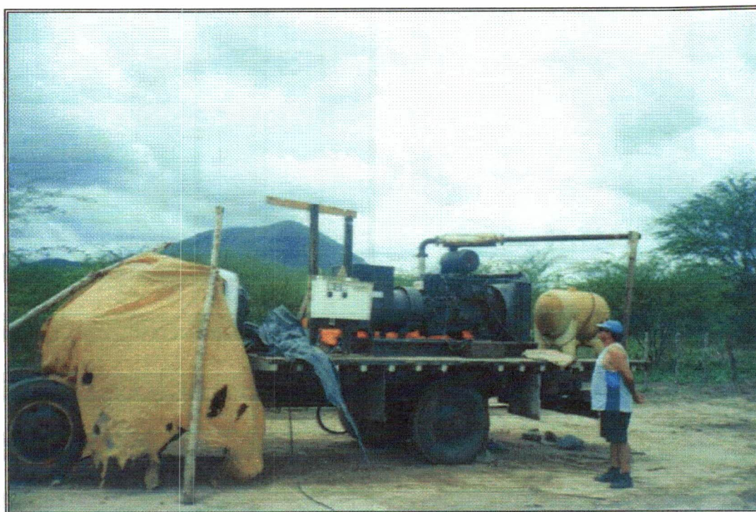
Foto 04 – Gerador móvel, para acompanhar os serviços ao longo da estrada.
